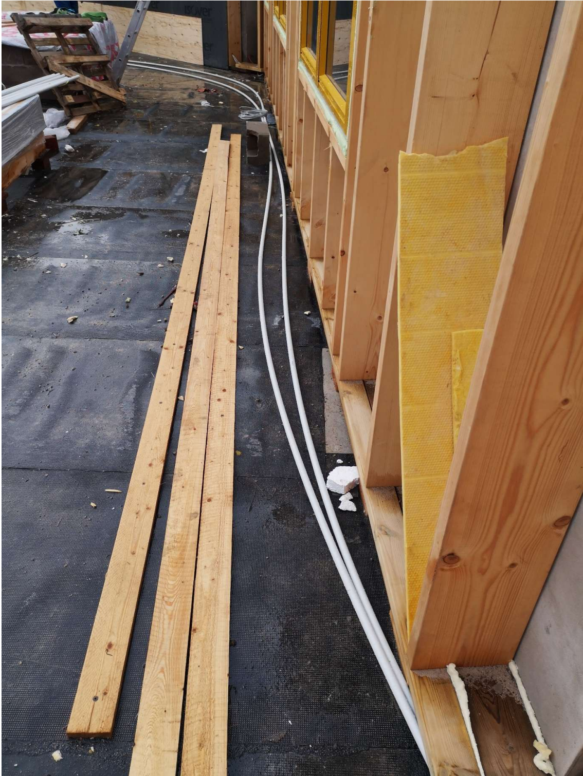
FOTO 1. Välisseinatarind on projekteeritud ja ehitatud kergtarindina. Ehitaja on paigaldanud välisseinatarindi puitprussidest kartkassi katuse betoonpaneelidest kandetarindile, isolatsioonitarindi aurutõkkekihile. Välisseinatarindi kattekihist pääseb arvukate liidetest ja pragudest sademevesi sisse. Veetiheda sokli puudumise tõttu pääseb sademevesi katusetarindisse ja sisekonstruktsioonidesse.
