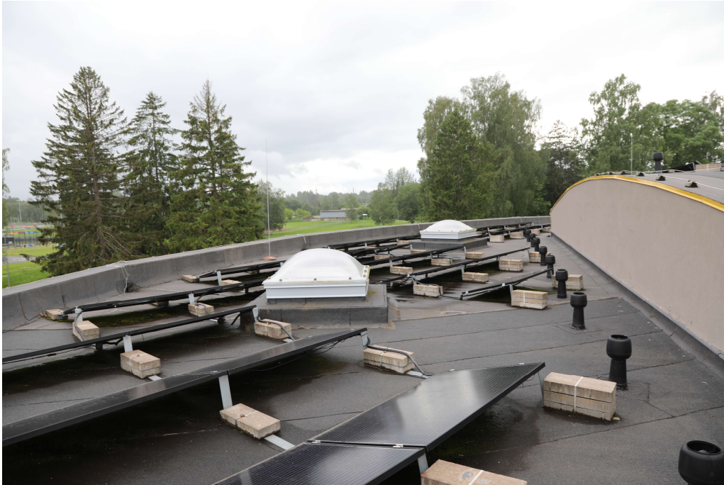
Foto 11. PV on paigaldatud pindpaigaldisena katusetarindi hüdroisolatsioonikihile. PV paneelid toetuvad lattrauast alusele, mille paigal püsimiseks on paigaldatud kiviplokkidest ballast.
