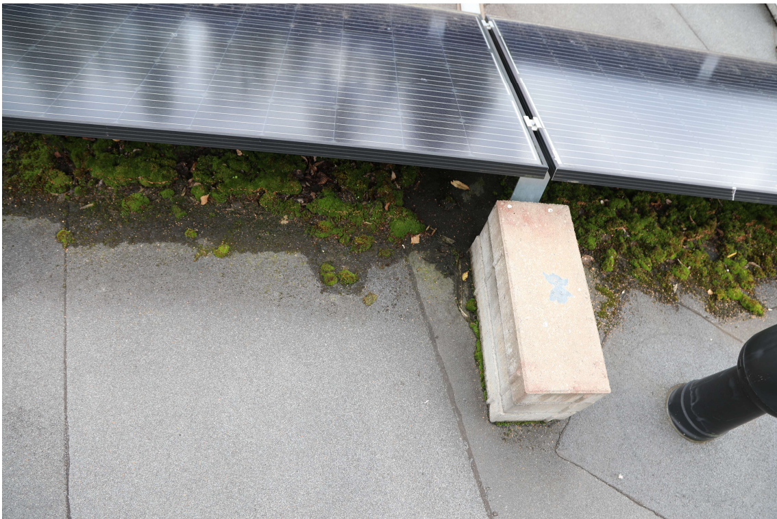
Foto 16. Lahtised ballastikivid võivad nihkuda ja kukkudes hüdroisolatsioonikihti vigastada.
