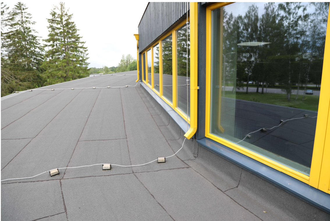
Foto 4. Vaade välimise äravoolusüsteemiga katusetarindi osale. Põhilised läbijooksud hoonekarbil on seina ja katusetarindite liitekohas.
