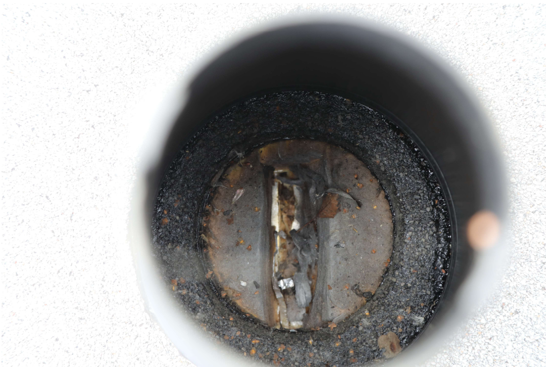
Foto 20. Difusiooniõhuti alla on sisse lõigatud nn difusioonikanalid. PIR soojusisolatsiooniga katusetarindis on difusiooniõhutid kui kanalid mõttetud. Kanali sisselõikamine PIR kihti kahjustab soojusisolatsioonitoodet. PIR soojusisolatsiooni alumiiniumfooliumist laminaadikihti ei tohi lõhkuda.
