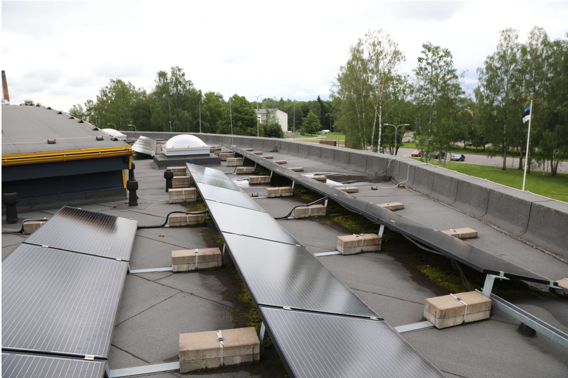
Foto 9. PV on paigaldatud katusetarindi hüdroisolatsioonihile pindpaigaldisena betoonplakkidest ballastiga.
