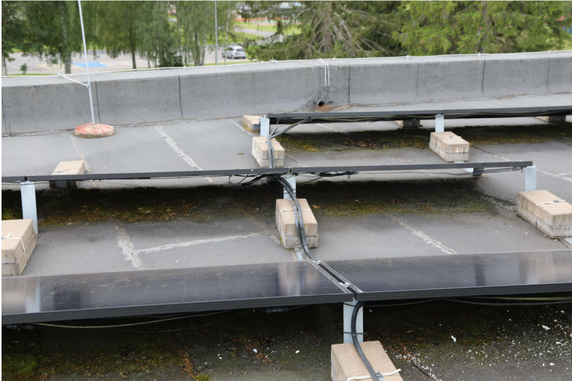
Foto 17. PV alla koguneb prahti ja hakkab kasvama sammal. See eeldab katusetarindi täiendavat hooldust mitu korda aastas. Samal ja praht häirib sademevee äravoolu.
