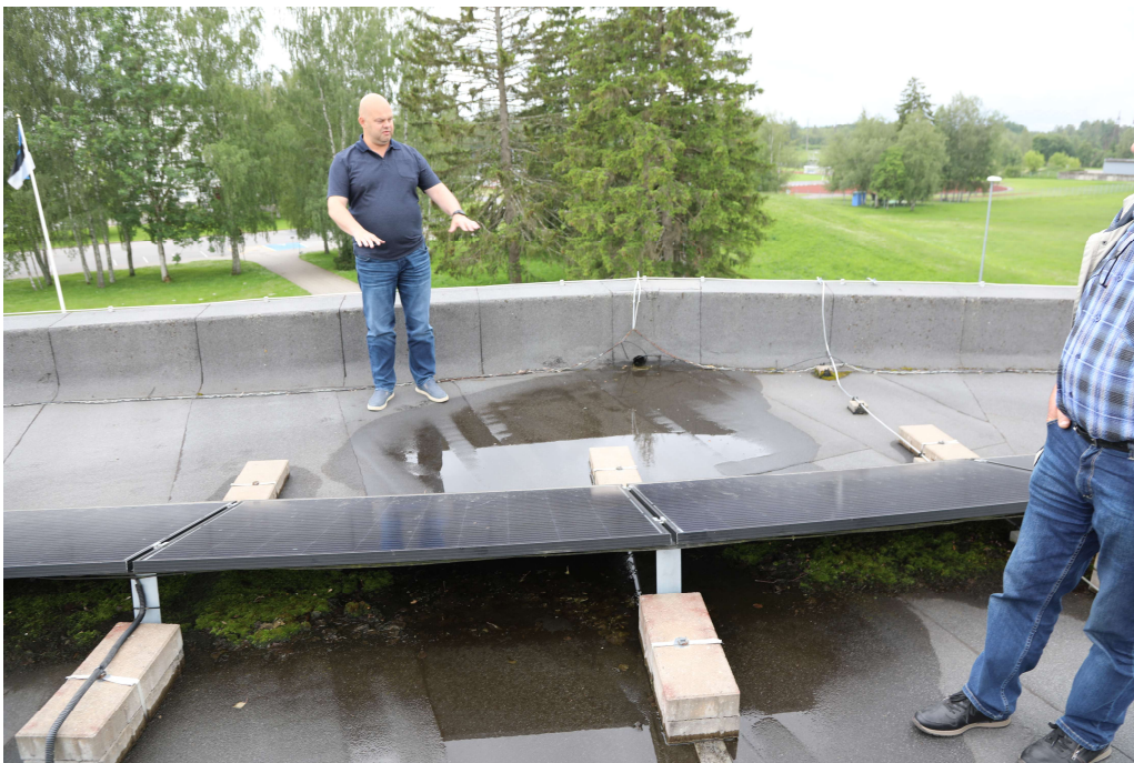
Foto 12. Katusetarindi soojusisolatsiooni pealmises kihis on kasutatud mineraalvilla (MW). Ilmselt on MW koormustaluvus liiga väike. PV süsteem tähendab katusetarindile nii staatilisi (omakaal) kui dünaamilisi (eelkõige tuulekoormus) koormuseid. Kui soojusisolatsioonikiht on väiksema koormustaluvusega tekkivad vajumid. Vastu katusetarindi hüdroisolatsioonikihti paigaldatud lattrauad häirivad sademevee äravoolu.
