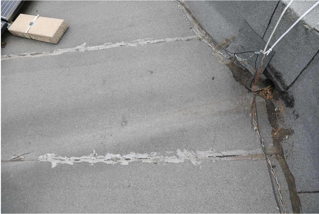
Foto 21. Sademevee äravooluks on paigaldatud veesülitid. Küttekaablid ja nende paigaldusketid häirivad oluliselt sademevee äravoolu ja soodustavad prahi kogunemist ning toru ummistumist.
