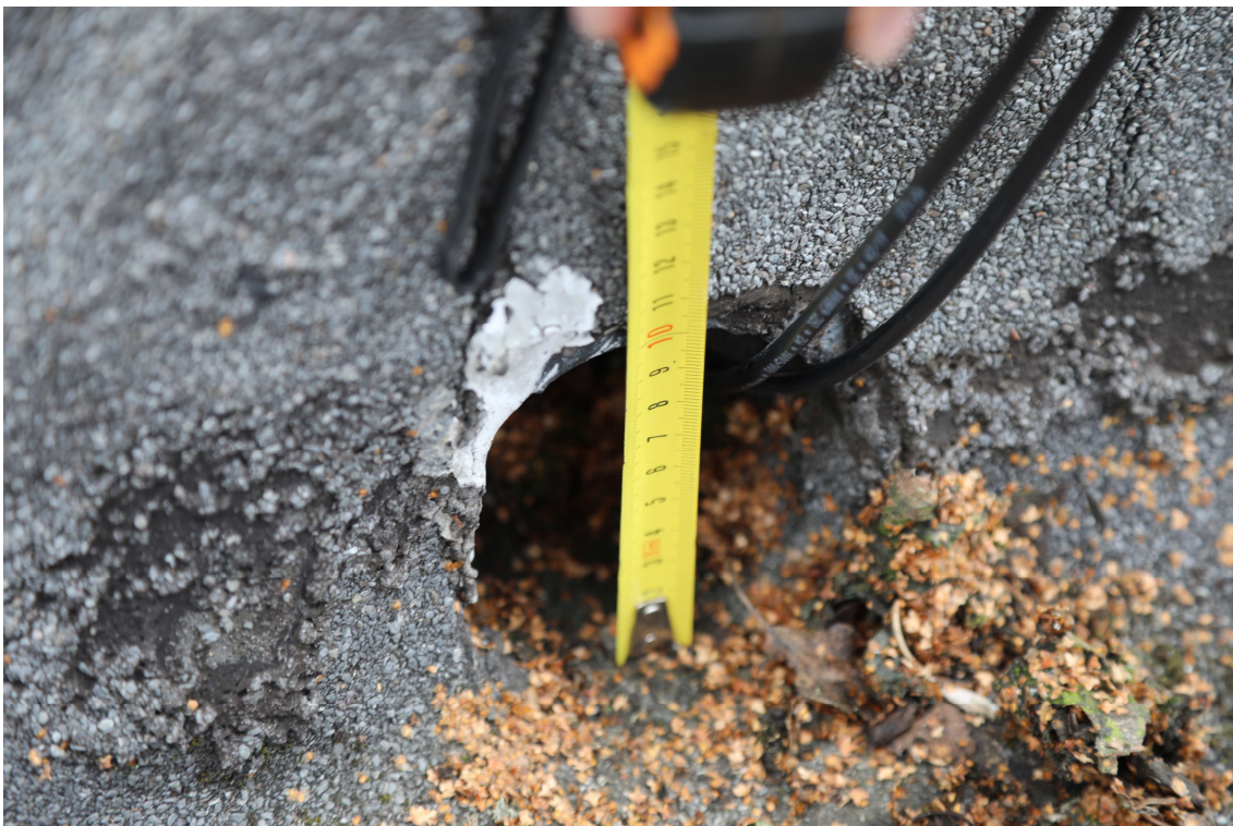
Foto 22. Sademevee süli toru läbimõõt on 100 mm.
