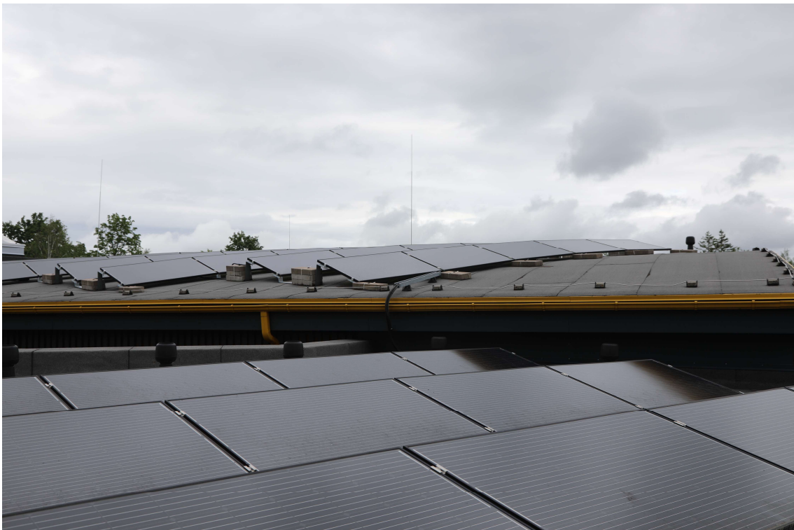
Foto 8. Keskmisele ja kõrgema katusetarindi tasapinnale on paigaldatud PV.
