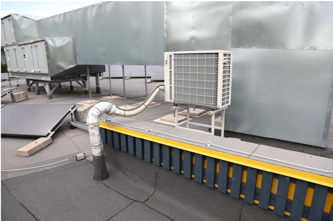
Foto 28. Vaade madalama katusetarindi kaldse osa ja kõrgema katusetarindi liitekohale. Improviseeritud läbiviik ei ole pikaajaliselt veetihe. Parapeti lahendus ei ole pikaajalise kestvusega. Seina ja katusetarindi liitekoht ei ole veetihe
