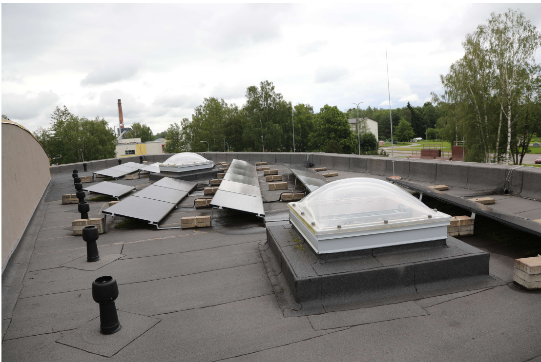
Foto 10. Katusetarindi erinevatele osadele on paigaldatud kuppelaknad. Katuseakende juures olid tellija väitel läbijooksuprobleemid, mis kadusid peale remonti ja uute kuppelakende paigaldust.
