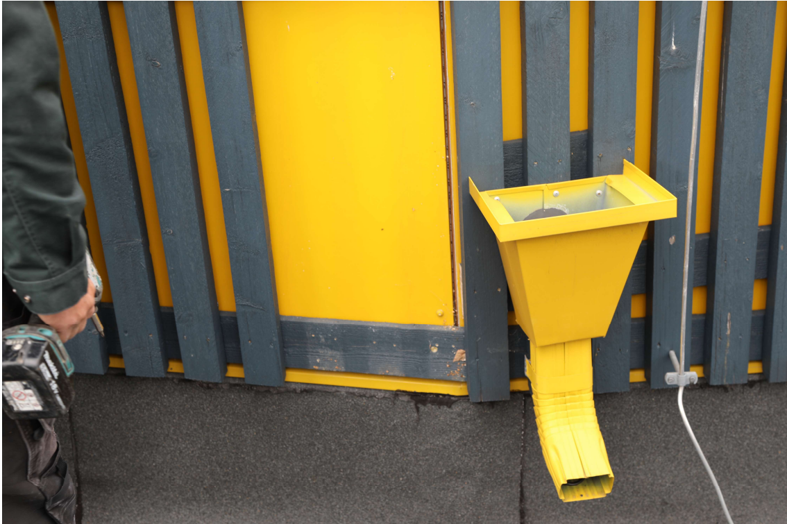
Foto 23. Seinatarindi pinnale on paigaldatud veekoguja ja allaviigutoru. Ülemise katusetarindi süli toru suubub veekogujasse.
