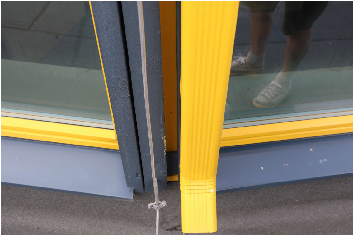
Foto 3. Akende ja seinatarindi liited ei ole veetihedad. Kuna katusetarindi ja seinatarindi liitekohas puudub toimiv soklilahendus, siis pääseb läbi fassaadikatte ja liidete pilude sisse sademevesi, mis liigub edasi katusesse ja sisekonstruktsioonidesse.
