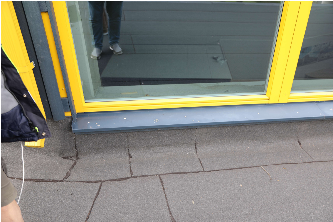
Foto 4 Aknapleki ja fassaadi liited ei ole veetihedad.
