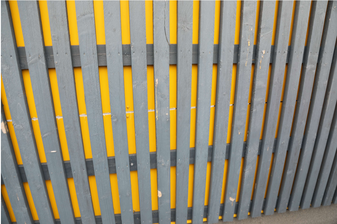
Foto 10. Seinatarindi tsementplaatidest katte liitekohti on püütud tihendada pealemääritud mastiksiga. Laudise taga ei ole võimalik tihendust teha. See ei ole toimiv lahendus.
