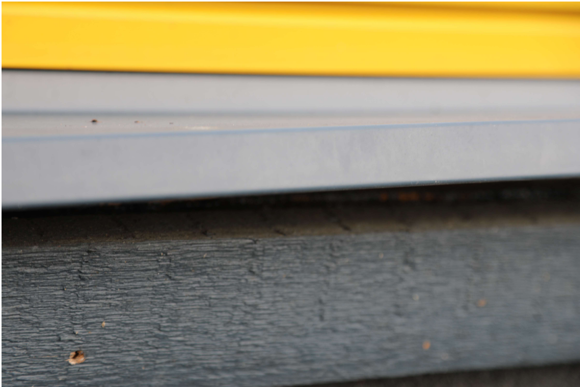
Foto 6. Aknaaluse sokliosa ja akna liited ei ole veetihedad.
