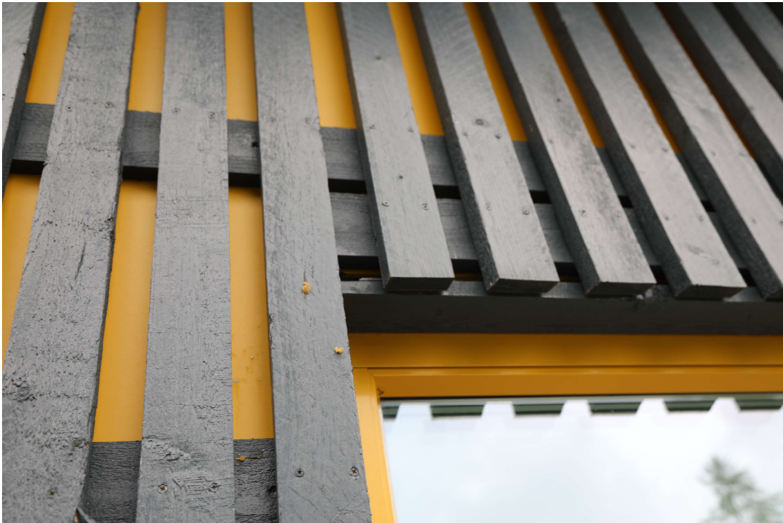
Foto 16. Seinatarindi ja akna ülemise serva liited ei ole veetihedad.
