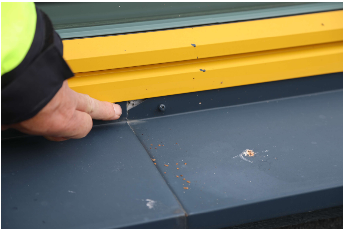
Foto 5. Aknapleki ja aknaraami liited ei ole veetihedad.
