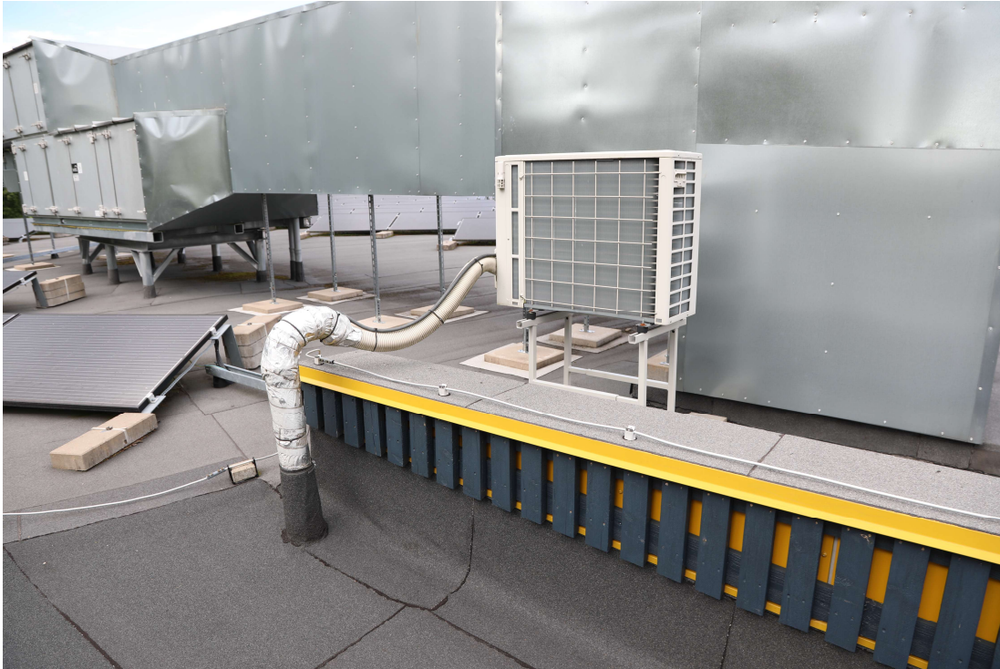
Foto 8. Puitdekooriga kaetud sein ja parapetiosa. Seinatarindi tsementplaatidest katte liited ja liited teiste ehitusosadega ei ole veetihedad. Kuna katuse ja seinatarindi liitekohas puudub toimiv soklilahendus pääseb sademevesi katusetarindisse ja sealt edasi siseruumidesse. Enamik läbijooksukohti on sein ja katusetarindi liitekohtades.
