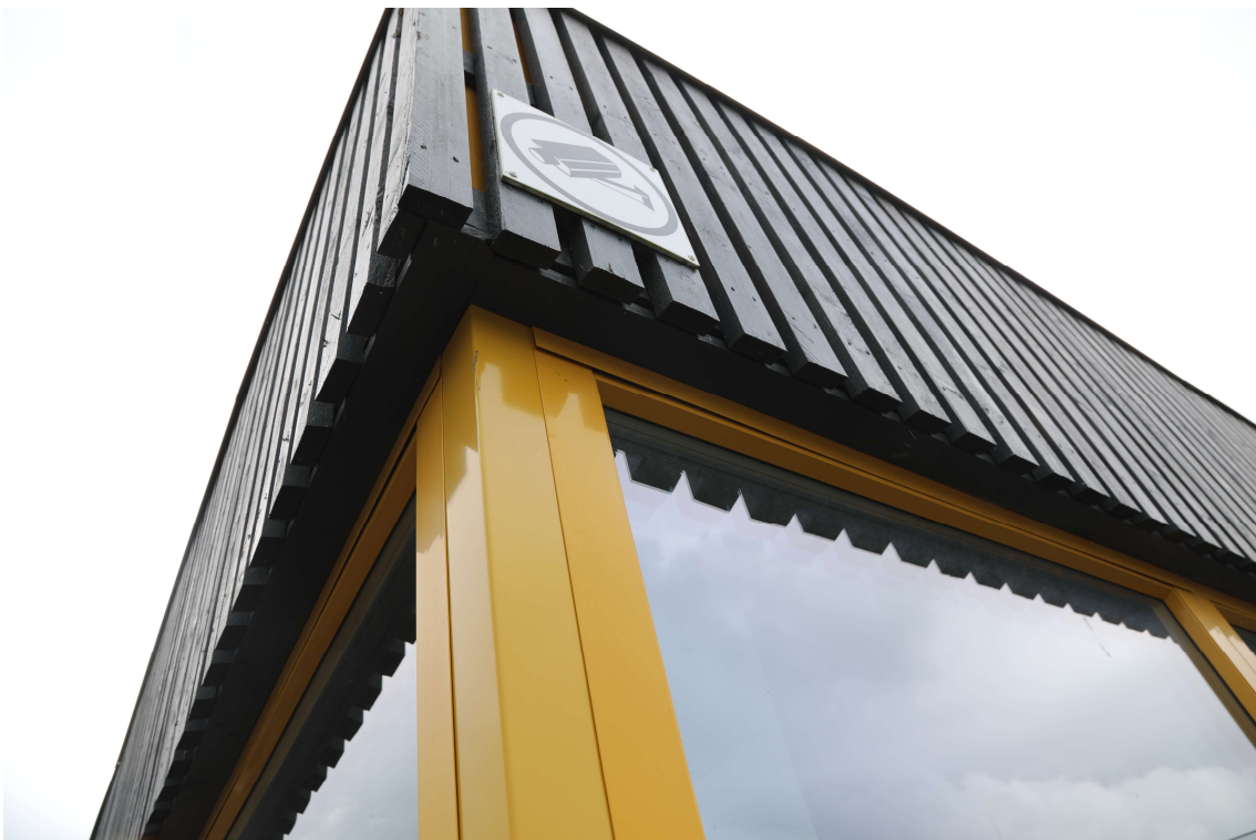
Foto 17. Akna ja seinatarindite liited ei ole veetihedad. Võimalik, et veetihedad ei ole ka akende nurgaliited.
