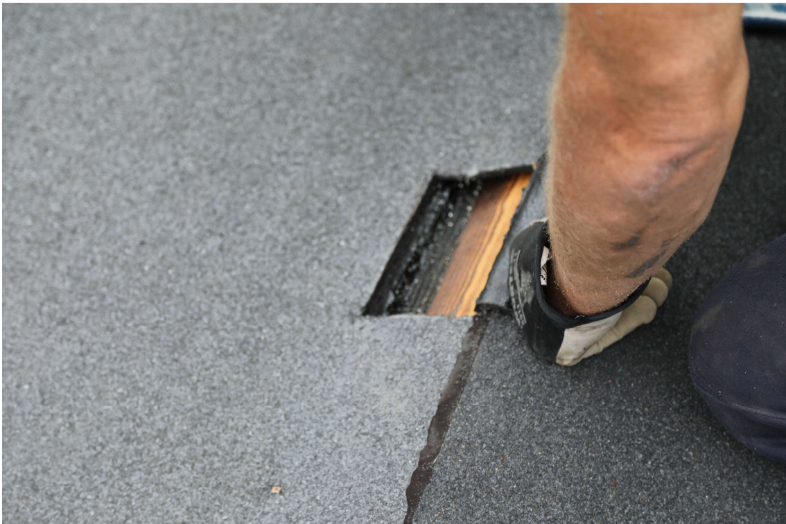
Foto 8. Katusetarindi räästal liitub soojusisoleeritud katusetarind külma räästaosaga. Ülemineku sujuvamaks muutmiseks on kasutatud puidust kolmnurkliistu.
