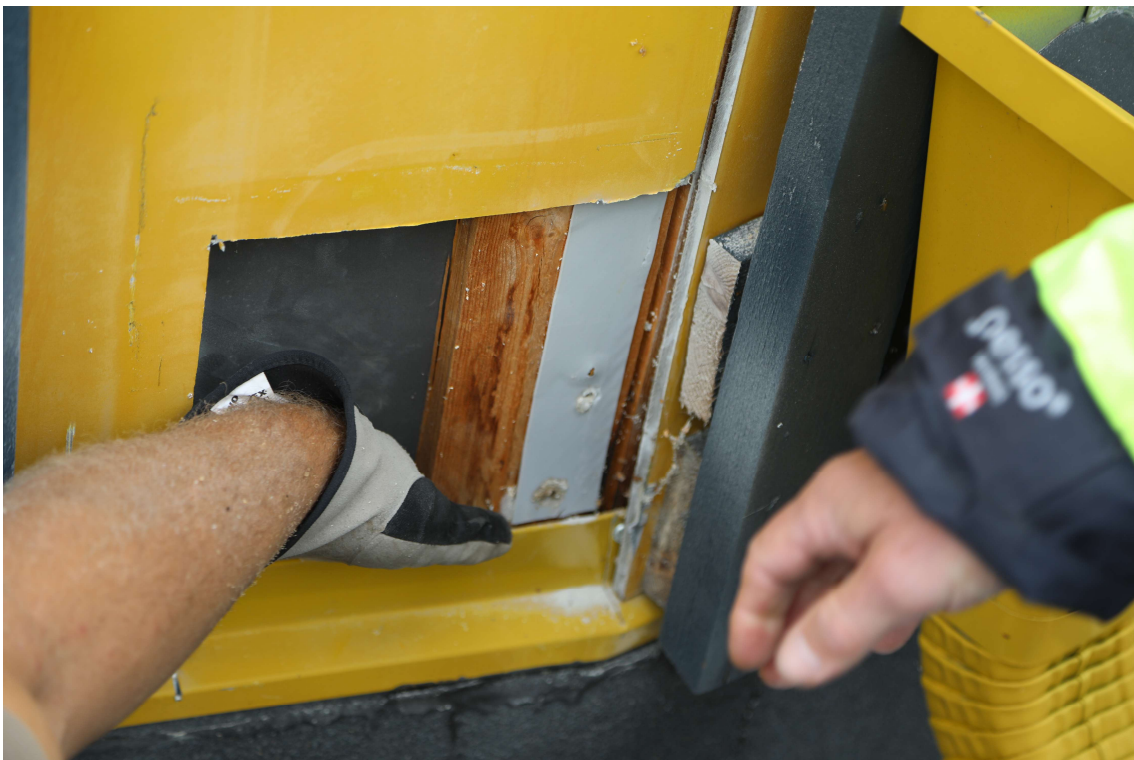
Foto 6. Tuulduva seinatarindi ja katusetarindi liitekohas puudub toimiv veetihe sokliosar. Kui seinatarindisse pääseb sademevesi, siis liigub see takistuseta katusetarindisse.
