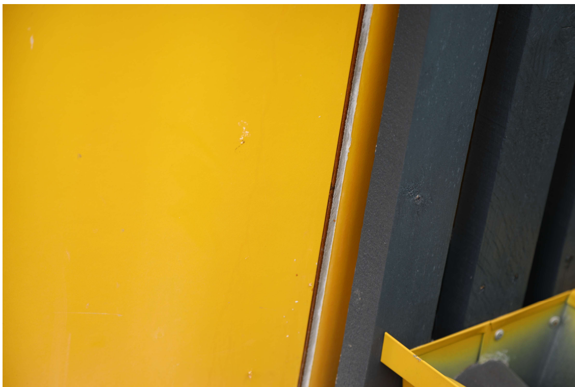
Foto 2. Tuulduva fassaadi katteplaatide liitekohad ei ole ilmastikukindlad.
