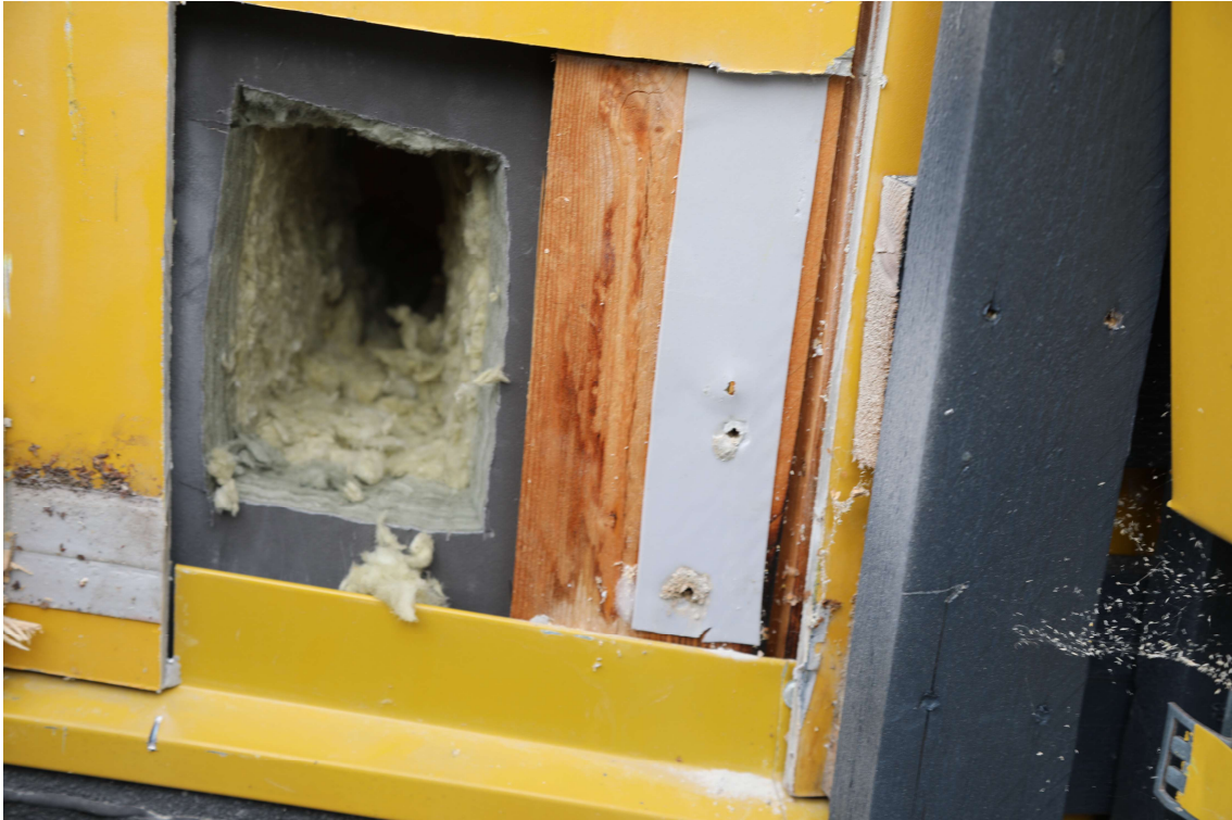
Foto 9. Seinatarindi ja katusetarindi liitekohta paigaldatud L kujuline plekkprofiil ei taga liite veetihedust.
